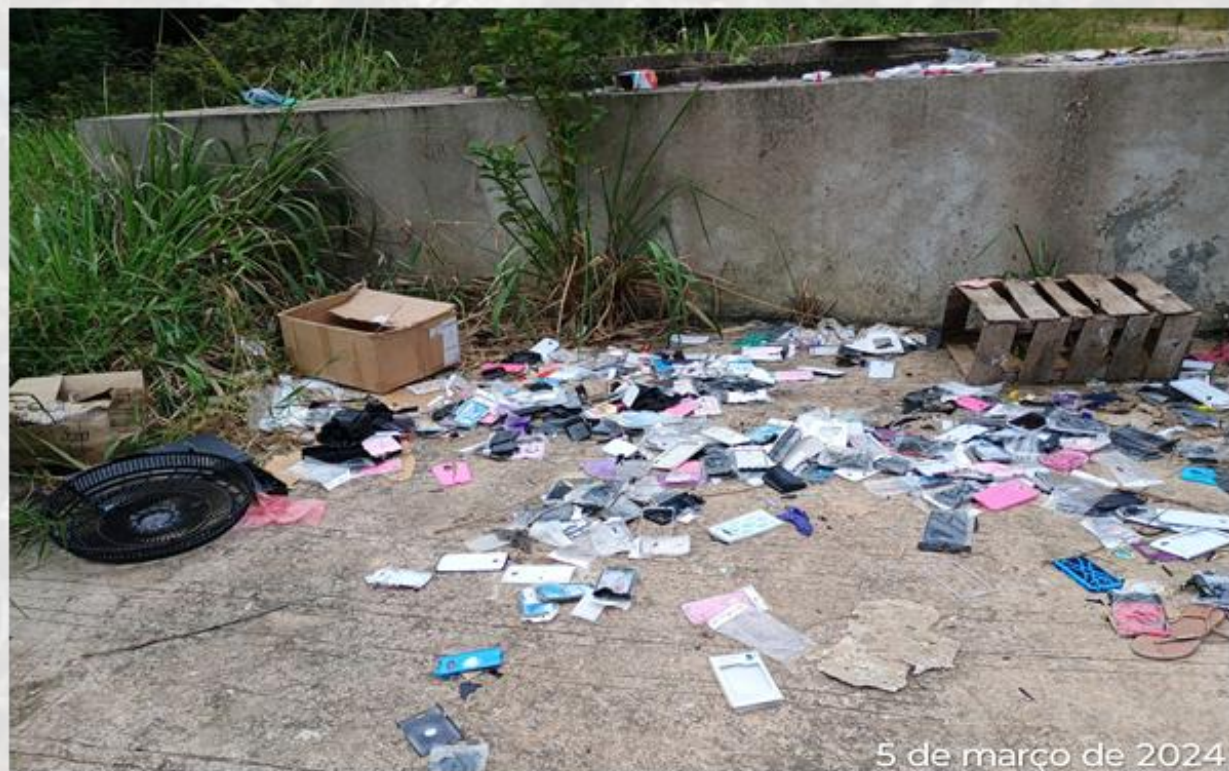
Aspecto da Fossa Séptica que vem sendo operada irregularmente, com o lançamento de resíduos que não são RSSS .
