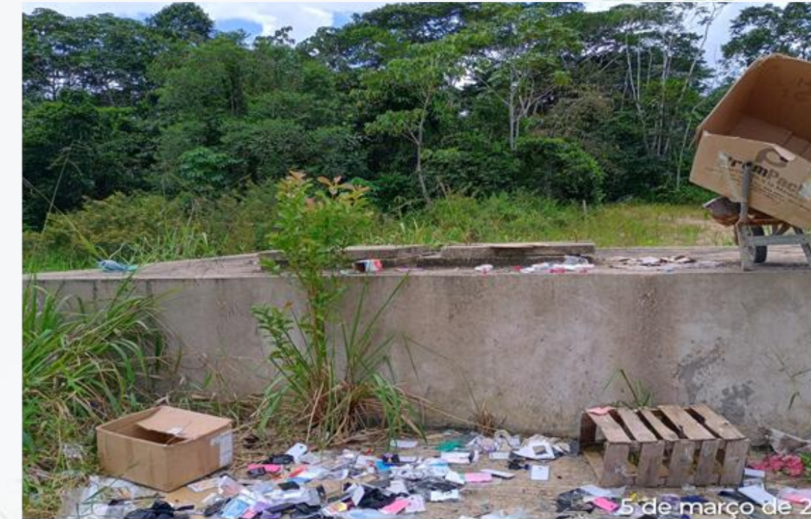
Aspecto da Fossa Séptica que vem sendo operada irregularmente, com lançamento de resíduos que não são RSSS .
